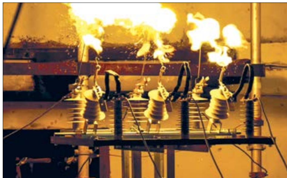
Test de comutație la separator de sarcină
